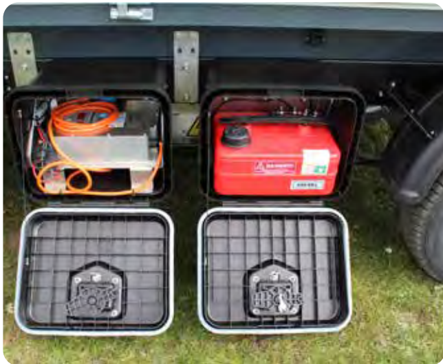
Linke Box: Ladegerät mit 220 Volt Stecker Rechte Box: Dieseltank für Webasto Heizung
